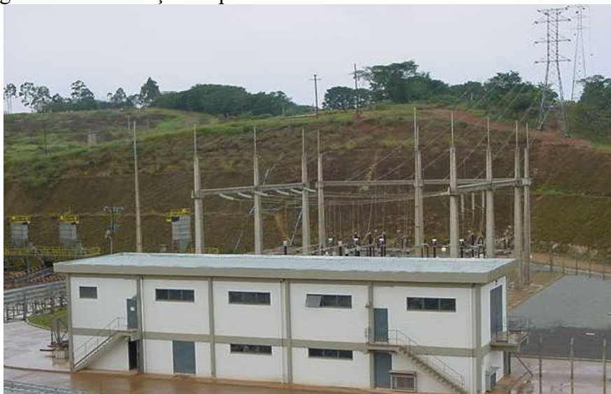
Figura 15 - Subestação da planta industrial
